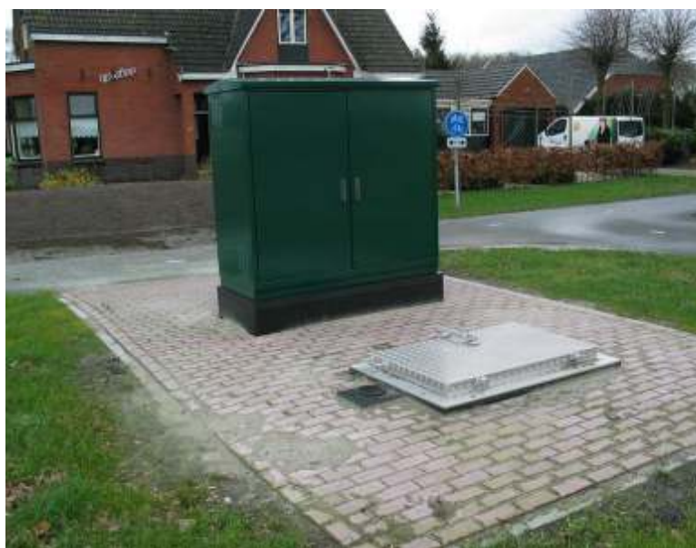
Rioolgemaal Foto: open bron
